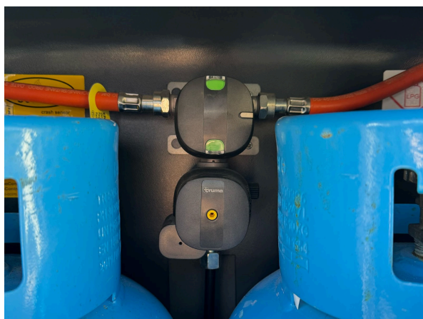
Slika 5.5.: Oba ventila najdete v prostoru za jeklenke
